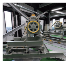
機械室 Machine Room
